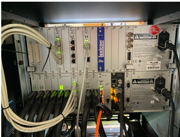
Abbildung 8: Local Rack der Vi400 (Quelle: Eigenes Foto)
